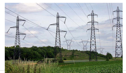
Fig. 9 : Transport d'électricité à longue distance - Source : Spedona/JH Mora [CC BY-SA 3.0 ( http://creativecommons.org/licenses/by-sa/3.0/ )], via Wikimedia Commons
